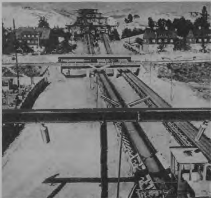
70. Taśmociągi do transportu nadkładu i węgla brunatnego w kopalni „Turów”
