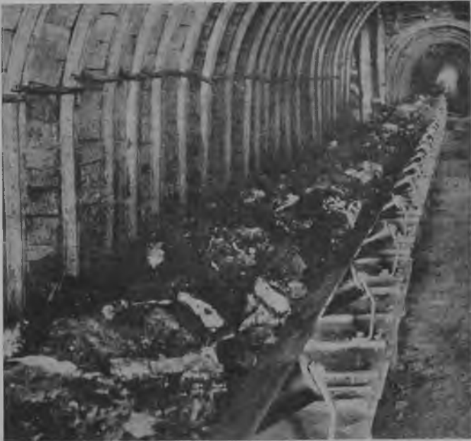
94. Przenośnik „Feneplast Conveyor Belting” zainstalowany w kopalni brytyjskiej
